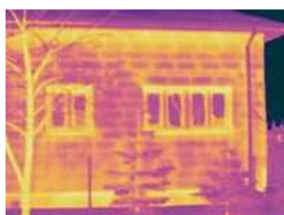
Mostki termiczne w budynku, jakich jest u nas wiele – na połączeniu ścian i dachu, ścian fundamentowych i przyziemia, wokół okien, a nawet na spoinach pomiędzy bloczkami (fot. Xella)
