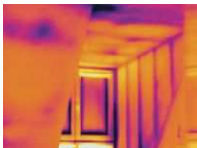
Wyraźnie widoczne mostki termiczne dookoła okna, na krawędziach szyb, stanowią je również drewniane belki konstrukcyjne lukarny (fot. Rockwool)
